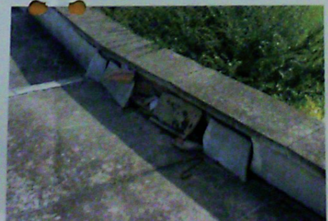
NAPRAWA POWIERZCHNI FAKTUROWEJ dla wyrównania podłoża płyty styropianowe gr 2 cm, następnie wykonać tynk cienkowarstwowy mineralny na siatce wzmacniającej, malować farbami silikatowymi.
